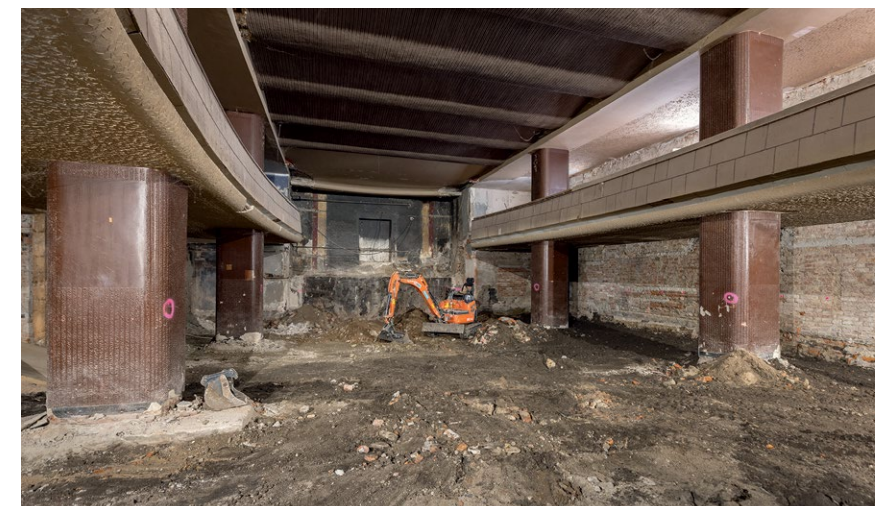
↑ Rekonstrukce bývalého kina odhalila mnoho skrytých nedostatků, především v oblasti statiky budovy.
