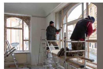
Rekonstrukce. Přípravné práce pro generální opravu střechy a fasády budovy Muzea moderního umění.
